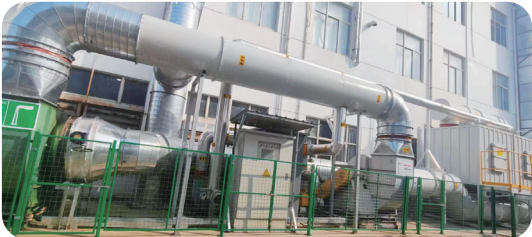
有機廢棄物處理設備
