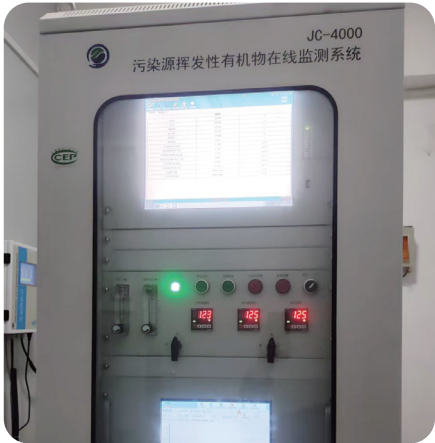
在線監測設備
